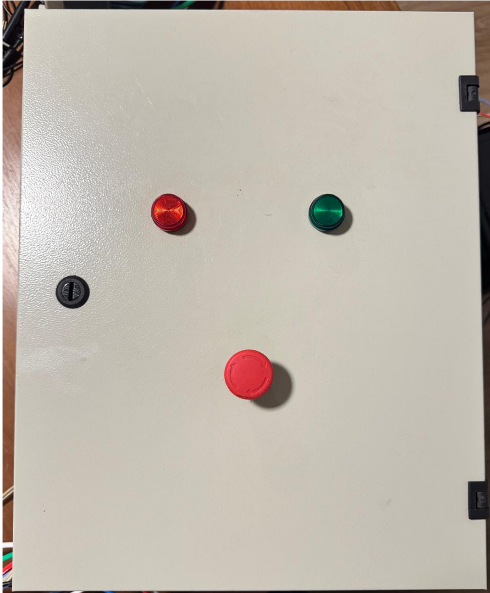
Figura 68 – Vista frontal da estação de recarga com sinalização luminosa.
