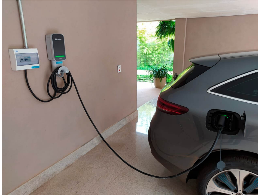
Figura 11 – Imagem do carregador Wallbox instalado.
