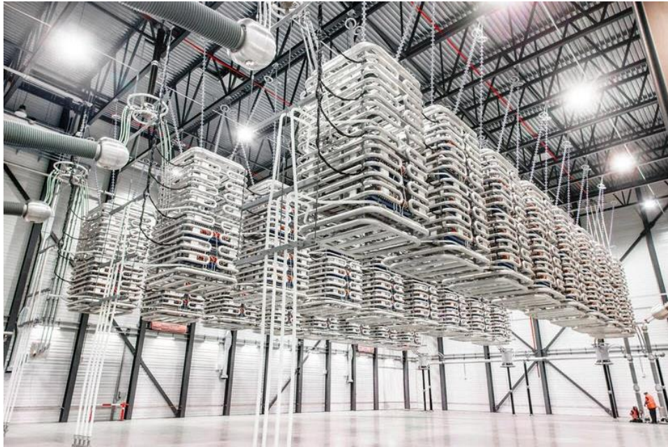
Figura 4 – Sistema HVDC da empresa ABB.
