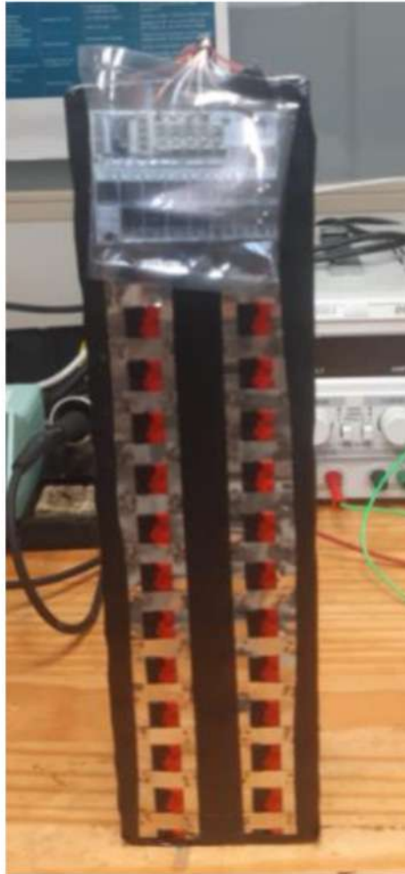
Figura 44 - Banco de baterias montado com o BMS 4S 100A instalado
