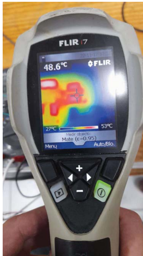
Figura 5.17 – Temperatura nos diodos da ponte retificadora
